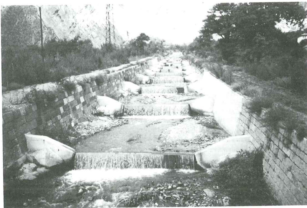
Photo 2 : Canal à biefs affouillables
