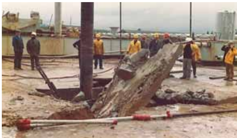
▲ Perturbation de la plate-forme de Melleray (Loiret) : aspiration des sables par la Loire souterraine lors de la foration des calcaires de Beauce.
