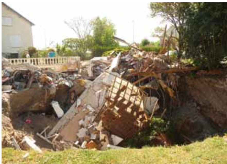
▲ Photo 2 : Effondrement à Saint-Pryvé-Saint-Mesmin. Le 22 mai 2010 une maison est entièrement engloutie par une « bîme » en liaison avec la circulation souterraine de l'eau de la Loire.
