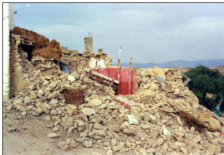
Photo 1 – Exemple de construction totalement détruite (région d'Izamourène au SW d'Al Hoceima). Example of totally destroyed building (Izamourène area SW of Al Hoceima).
