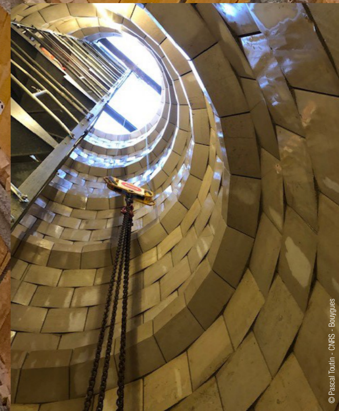
Vue de l'intérieur du puits une fois terminé. On distingue les claveaux en pierre maçonnée.
